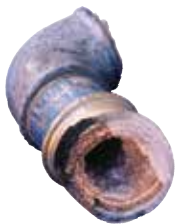
Vannrør med humus, oksider og kalk
