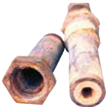
Vannrør før og etter rens
